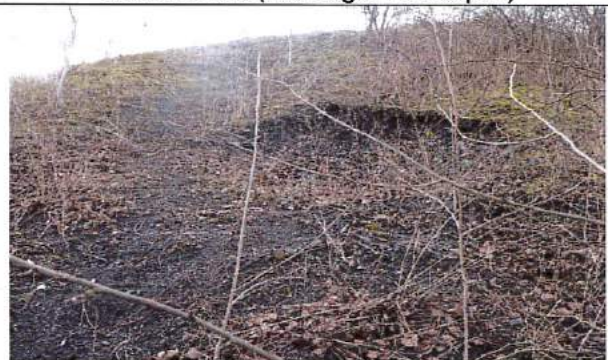
Photographie 4 : Vue du terril 71 en partie sud, désordre (glissement très superficiel) sur le cône
